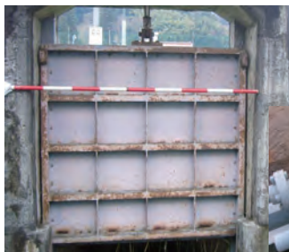
写真1 錆びが見受けられる扉体
