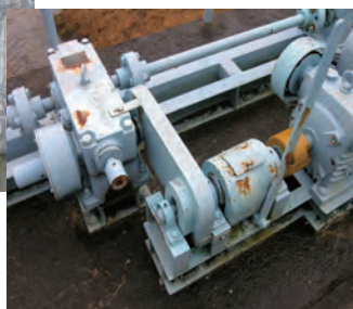
写真2 一部錆のある開閉装置
