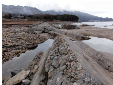
洗掘により倒壊した海岸堤防(南三陸町)
