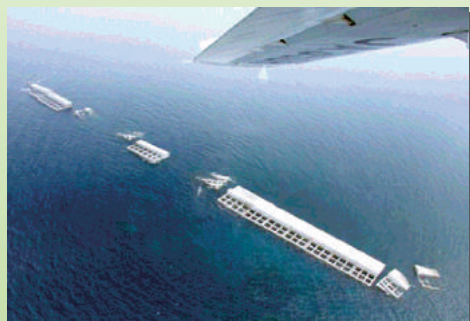
釜石港湾口防波堤の被災状況(いであ撮影)
