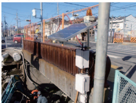
河道掘削に伴う橋台傾斜計測事例
