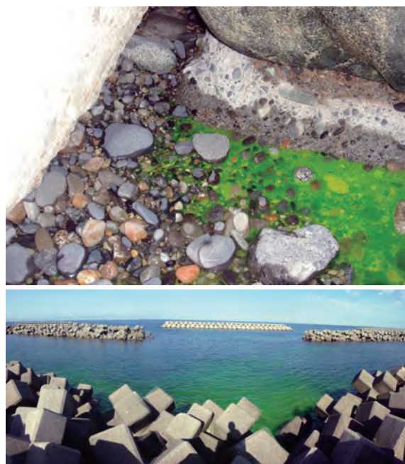
写真7 着色水の流出状況
