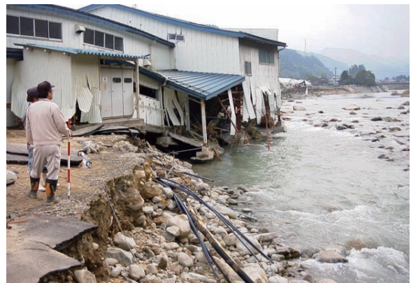
写真2 川上川(岐阜県宮川支川)の被災状況(2004年)
