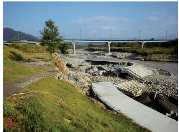
写真1 侵食による被害状況
