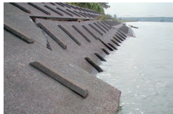
写真1 多摩川:2002年10月の洪水による護岸被災の事例
