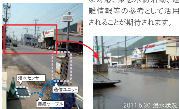
写真5 浸水センサー設置状況例 左:設置箇所(国道398号沿線) 右:降雨時の浸水状況
