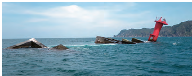
写真4 釜石港湾口防波堤の被災状況
