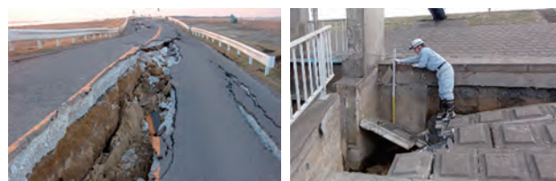
写真7 河川堤防や樋管の被災状況
