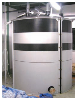
写真4 排水処理区画内タンク
