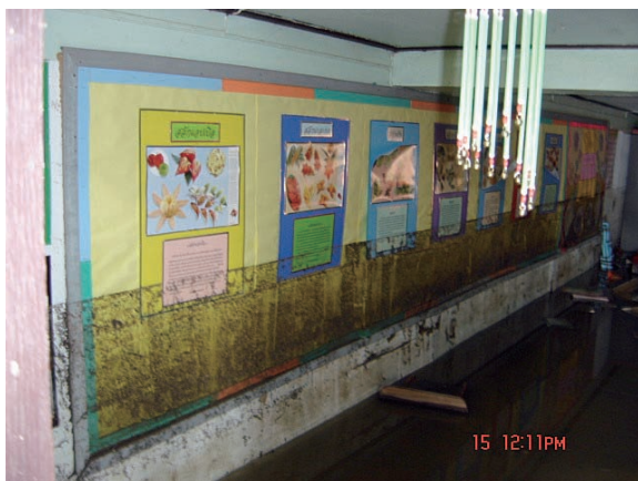
写真1 モデル校教室の壁に残る洪水の痕跡 (2005年8月のタイ北部大洪水直後の状況。 現在は、行政・住民・学校の共同活動で無事復旧している。)
