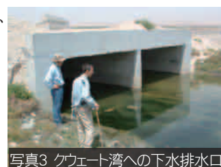
写真3 クウェート湾への下水排水口
