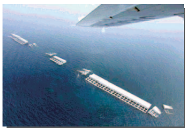
釜石港湾口防波堤の被災状況(いであ撮影)
