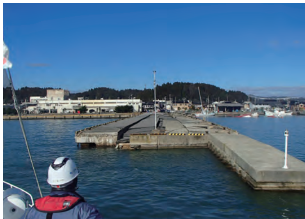
飯田港 被災状況調査
