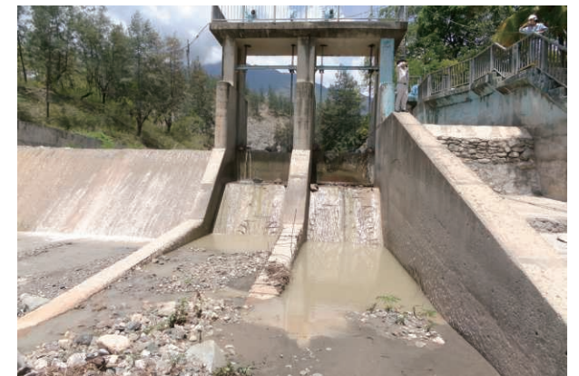
洪水時に流下する石等によってコンクリートが摩耗し鉄筋が露出した土砂吐きゲート
