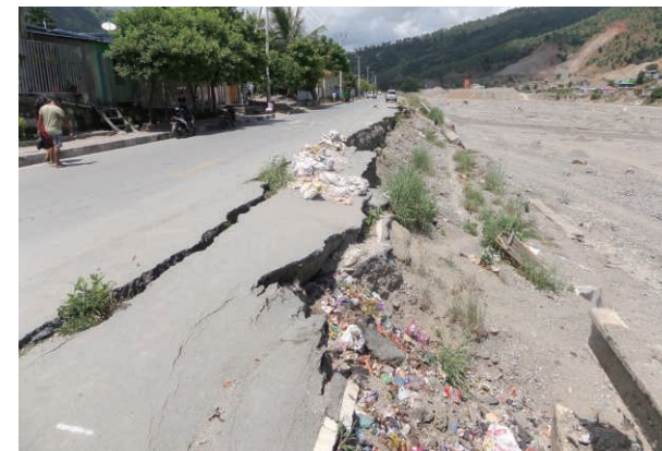
河岸浸食による護岸、道路の崩壊
