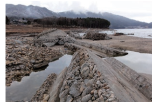
洗掘により倒壊した海岸堤防(南三陸町)
