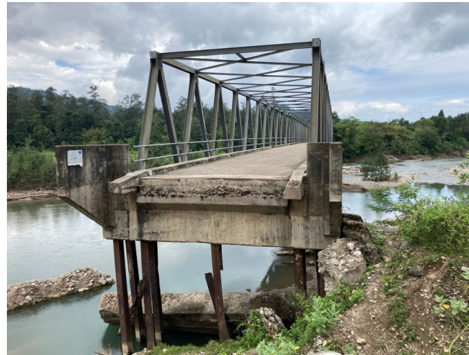
アプローチ道路が洪水によって流失した橋梁
