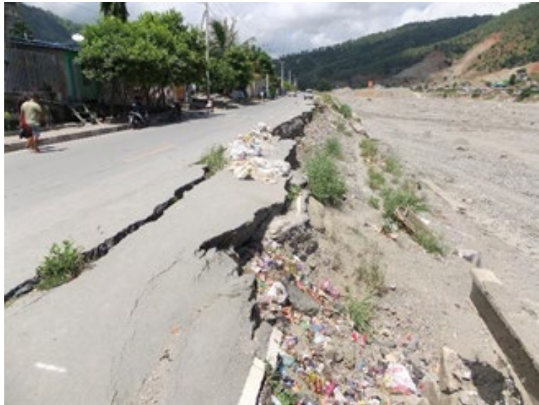
河岸浸食による護岸、道路の崩壊
