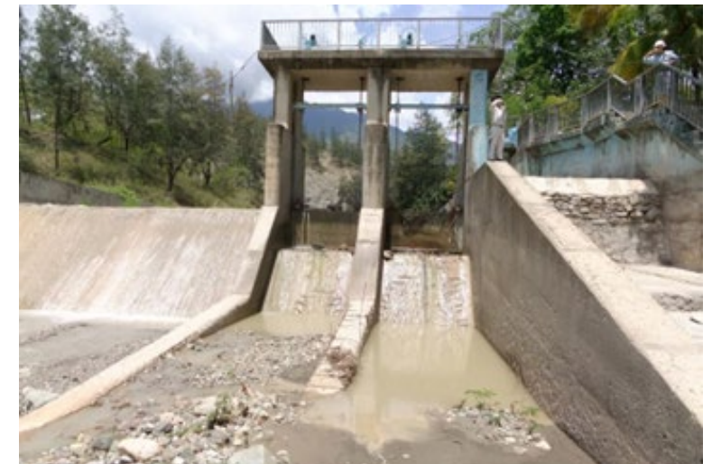
洪水時に流下する石等によってコンクリートが摩耗し鉄筋が露出、土砂吐きゲートの損壊
